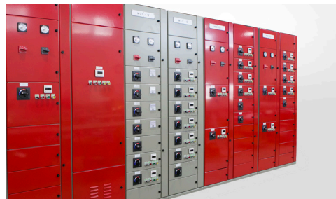
02 전동기제어반 Motor Control Center
